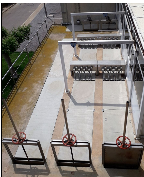
Figura 12. Canales de desinfección ultravioleta.
