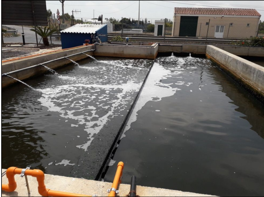
Figura 13. Canal de cloración.
