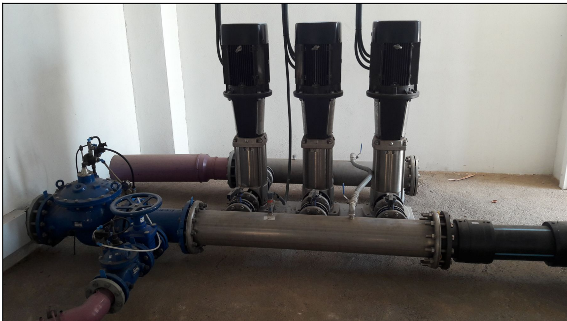
Figura 14. Grupo de bombeo para impulsión del agua regenerada.
